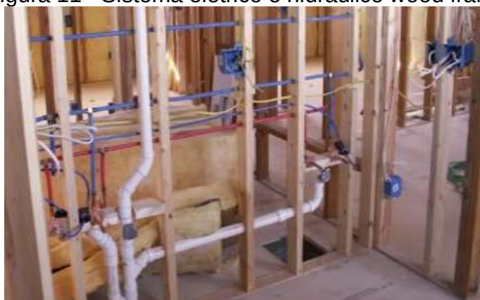
Figura 11 - Sistema elétrico e hidráulico wood frame
