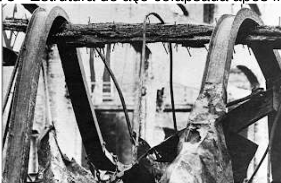
Figura 3 - Estrutura de aço colapsada após incêndio
