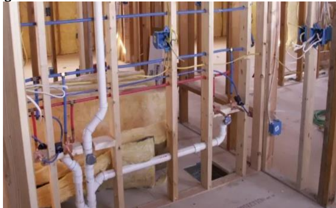
Figura 11 - Sistema elétrico e hidráulico wood frame
