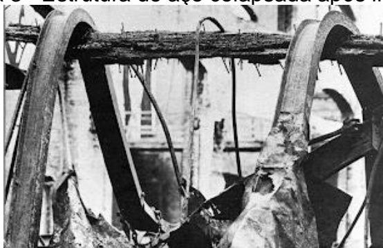
Figura 3 - Estrutura de aço colapsada após incêndio
