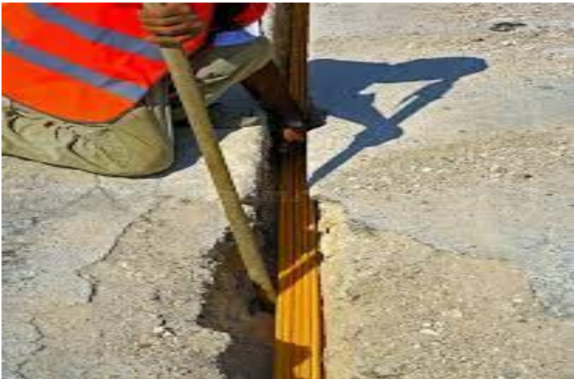
Figura 16– Acomodação do Cabo Óptico
