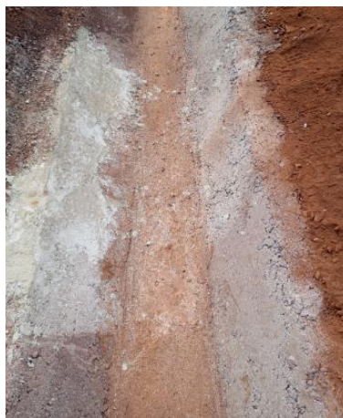
Figura 02 - Sarjeta 4A, entre estacas 08 e 09, apresentando porosidade
