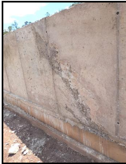
Figura 03 - Patologia “Broca” na parte externa da parede direita do canal 01
