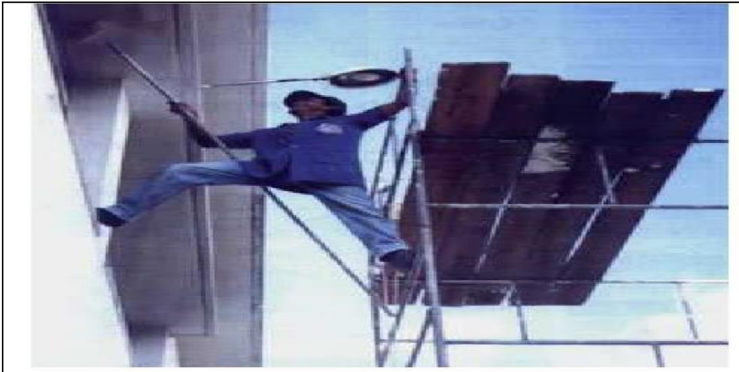
Figura 11 - Trabalho em altura sem os EPIs
