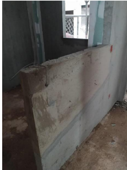
Figura 66 - Falta de concreto na parededivisória entre sala e cozinha
