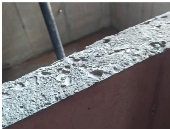
Figura 49 - Disgregação no concreto.
