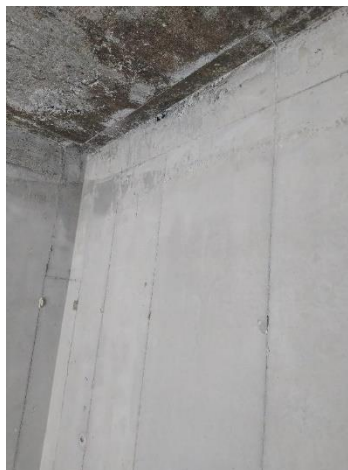
Figura 44 - Disgregação no concreto
