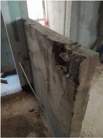
Figura 65 - Falta de concreto na parededivisória entre sala e cozinha.
