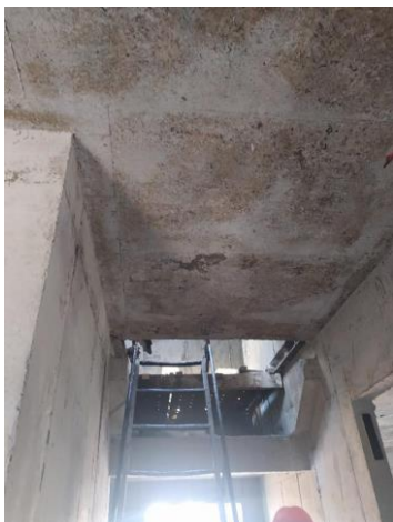
Figura 43 - Disgregação no concreto
