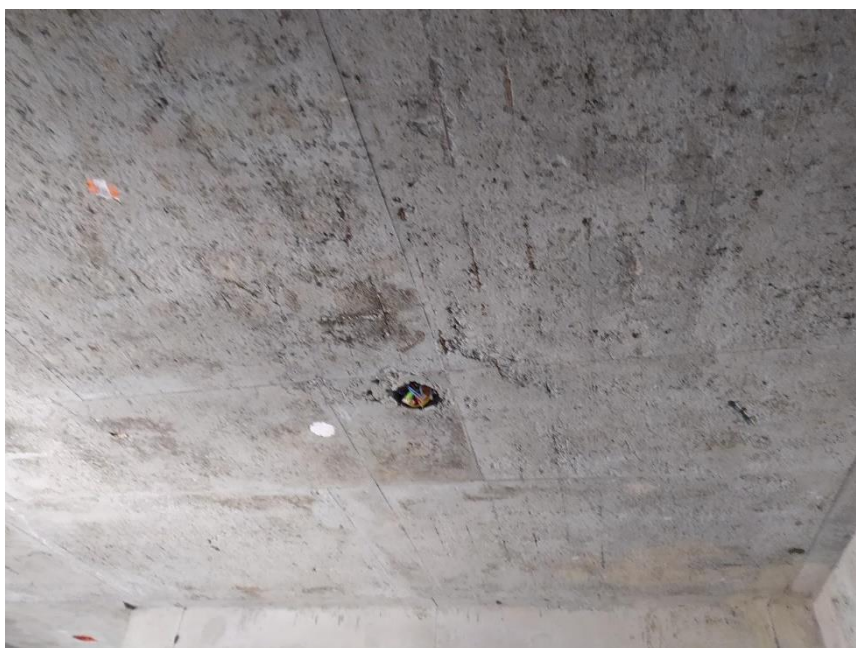
Figura 51 - Segregação no concreto
