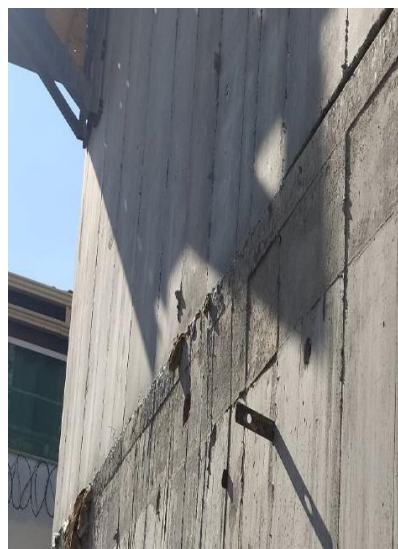
Figura 63 - Desencontro de elementos estruturais
