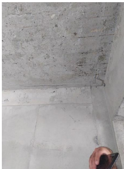
Figura 53 - Segregação no concreto
