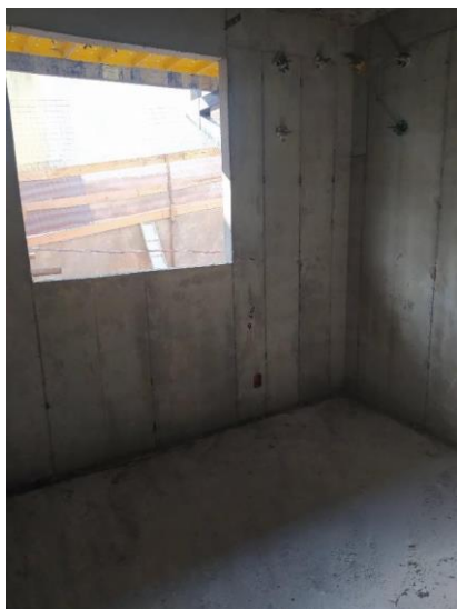
Figura 54 - Segregação no concreto.
