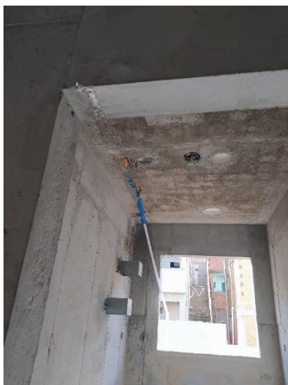
Figura 52 - Segregação no concreto
