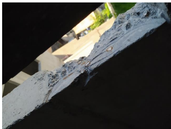
Figura 50 - Disgregação no concreto.
