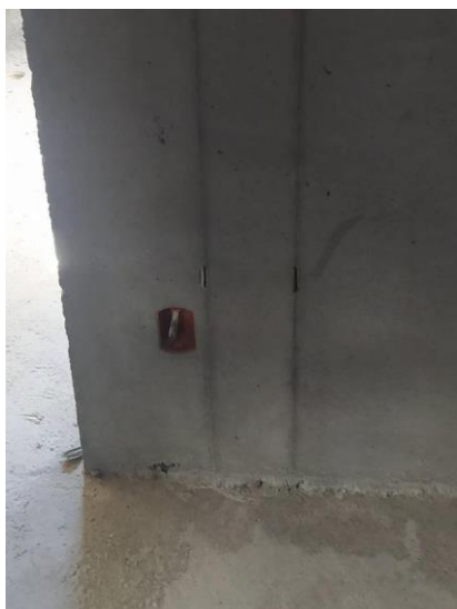
Figura 60 - Patologia no encontro laje-parede.
