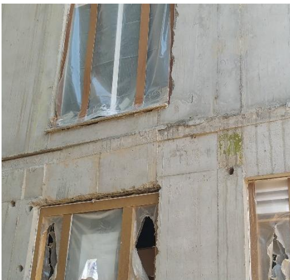
Figura 62 - Desencontro de elementos estruturais
