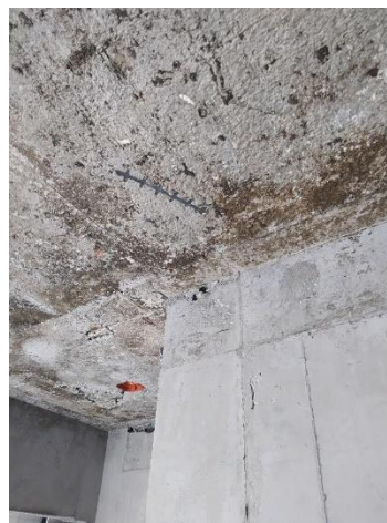
Figura 42 - Disgregação no concreto
