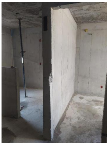
Figura 47 - Disgregação no concreto
