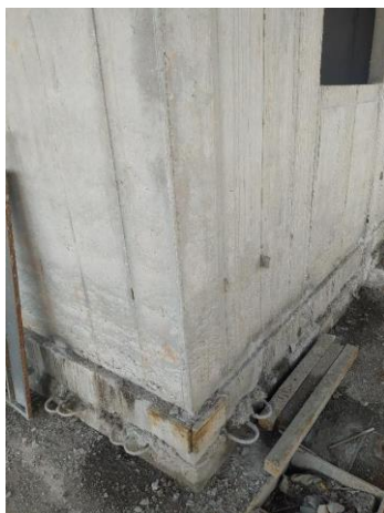
Figura 48 - Disgregação no concreto
