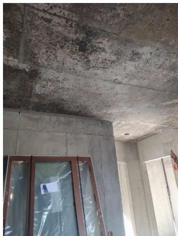
Figura 41 - Disgregação no concreto.
