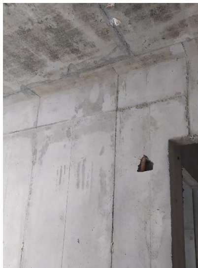
Figura 55 - Segregação no concreto.
