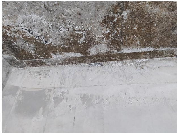
Figura 46 - Disgregação no concreto
