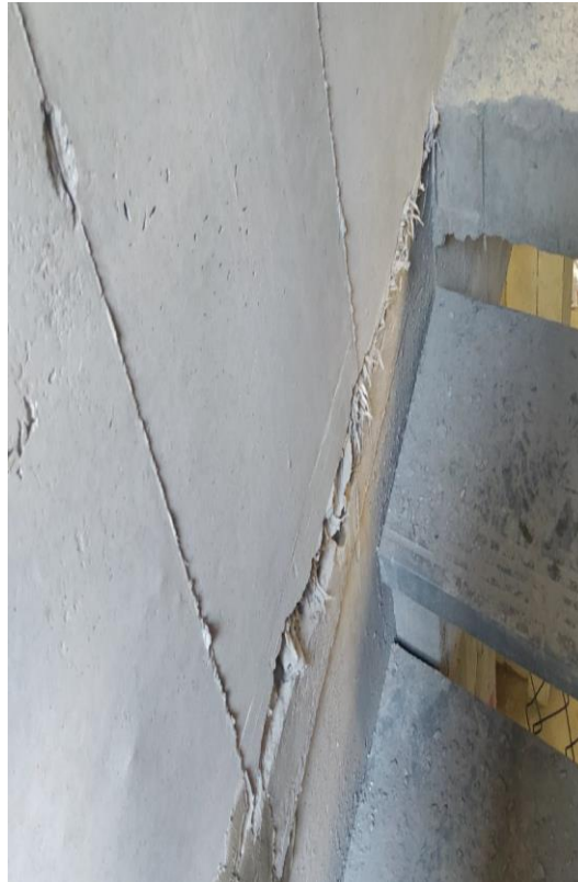
Figura 64 - Desencontro de elementos estruturais
