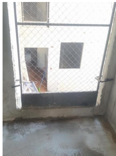
Figura 61 - Patologia no encontro laje-parede.
