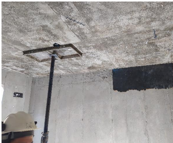
Figura 45 - Disgregação no concreto
