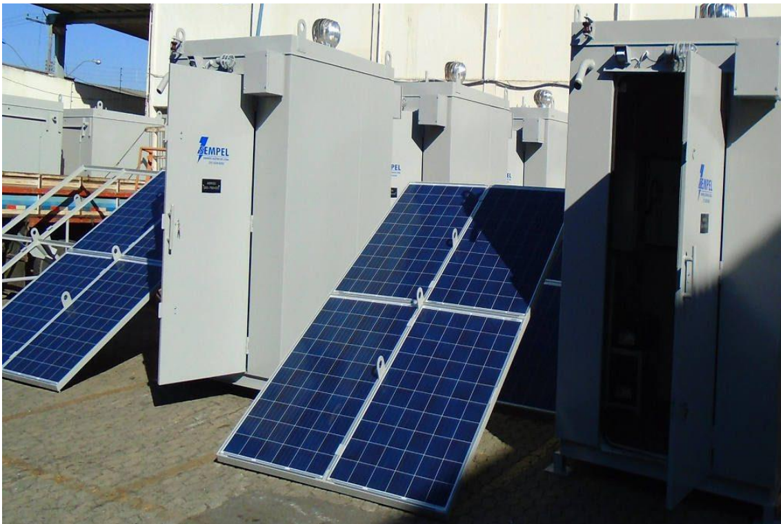
Figura 4 - Salas Eléctricas Enunciadoras de Alarme
