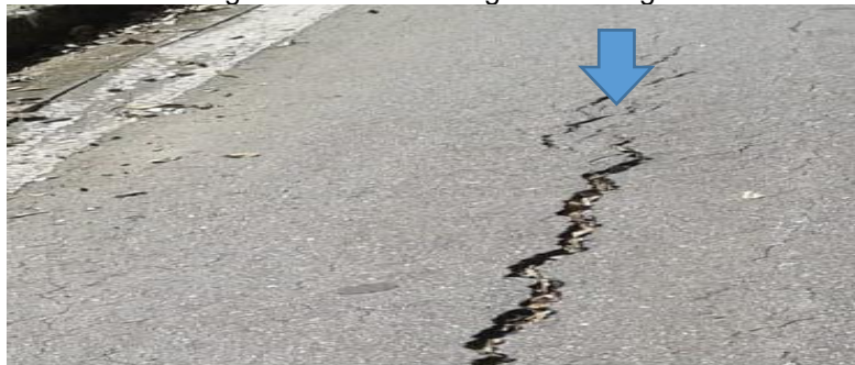
Figura 03 – Trinca longitudinal longa
