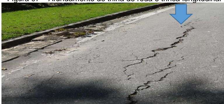
Figura 07 – Afundamento de trilha de roda e trinca longitudinal
