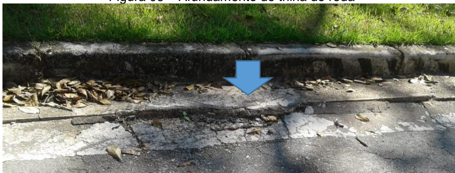
Figura 06 – Afundamento de trilha de roda
