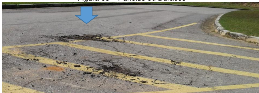
Figura 05 – Panelas ou Buracos
