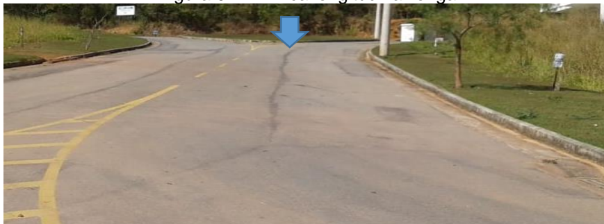
Figura 04 – Trinca longitudinal longa
