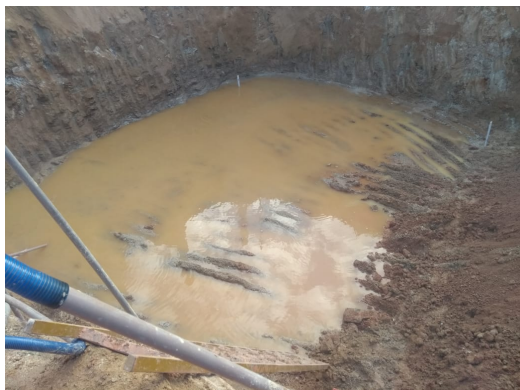
Imagem 1: Acúmulo de água
